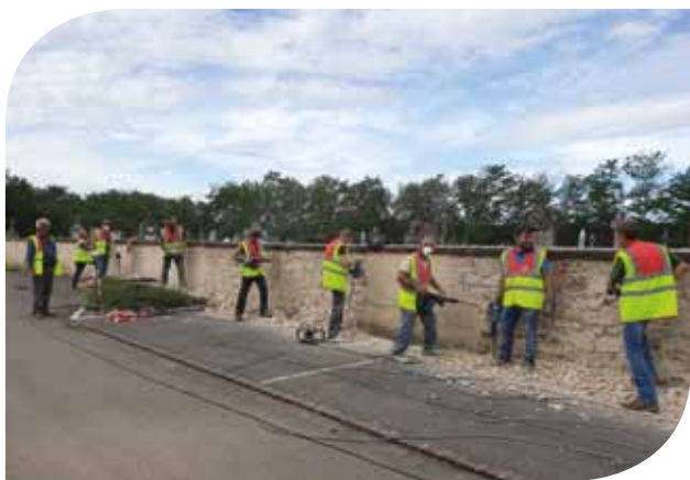
Décrépissage du mur du cimetière
